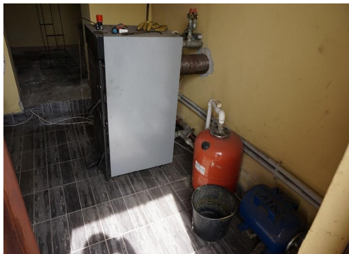
Figura 2 Centrală termică pe bază de cocs de 23 kW de la Căminul Cultural din Gălbiori (Comuna Crucea) (Sursă: Fotografie echipa de proiect ASE)
