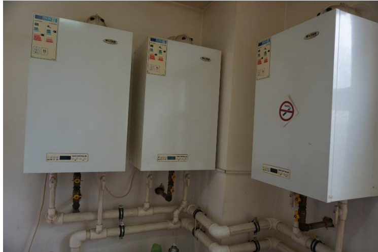
Poza 1: Centrale Primărie Crucea
