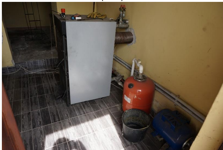
Poza 3: Centrală COCS (solid) Cămin cultural Gălbiori
