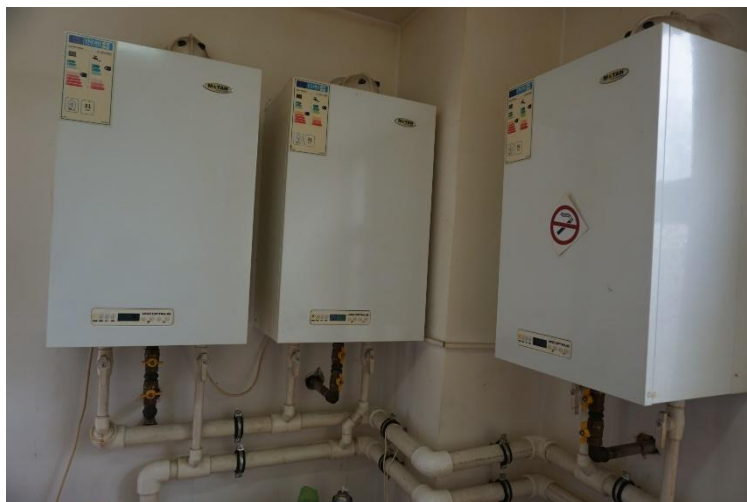
Figura 1 Centrale murale pe bază de Propan de 31 kW care încălzesc sediului Primăriei Crucea (Sursă: Fotografie echipa de proiect ASE)
